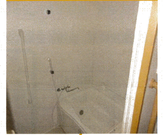
浴室 自動お湯はり、追い焚き機能・ シャワー・手摺付き、またぎ高さが 低いユニットバスになります。
