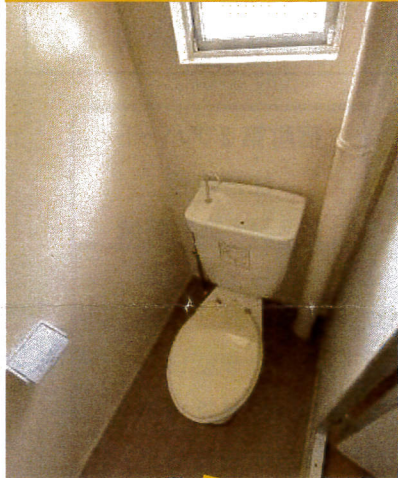
トイレ 使用水量が多い便器
